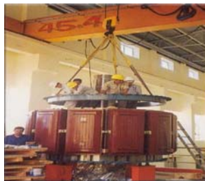
Tổ hợp Roto nhà máy thủy điện Sông Hình
