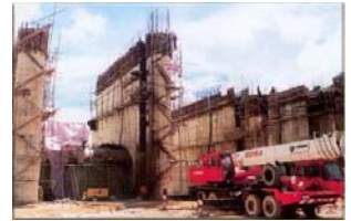
Thi công xây dựng đập tràn xả lũ - Dự án thủy điện Hàm Thuận - Đa Mi
